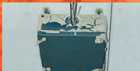
Ответственные коробки с подключенными кабелями после теста
